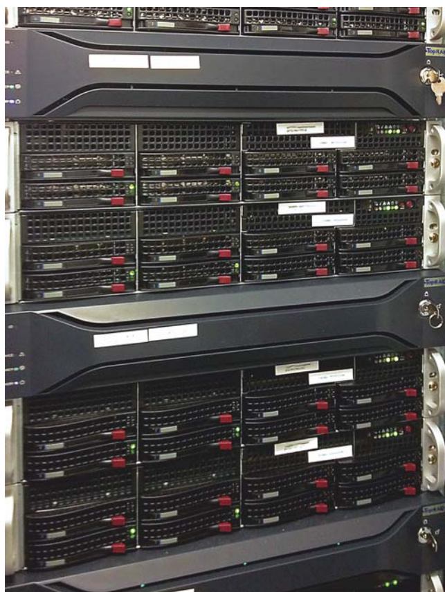
TopRAID Storage-Systeme als zentrale Ablage
